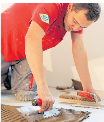
Ohne Widerrufsbelehrung können Handwerker leer ausgehen. Foto: amh
